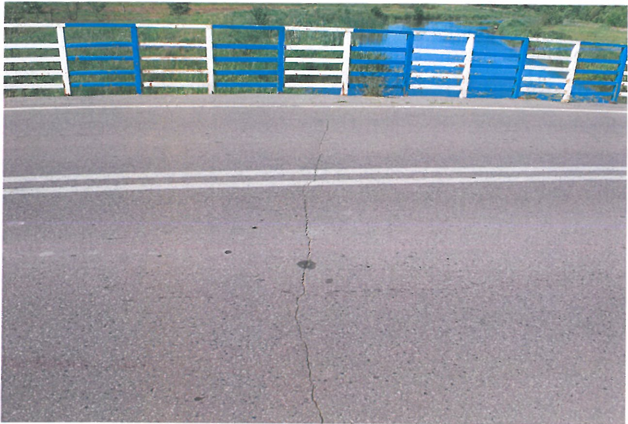
Fot. 9. Rysa nawierzchni jezdni nad podporą.
