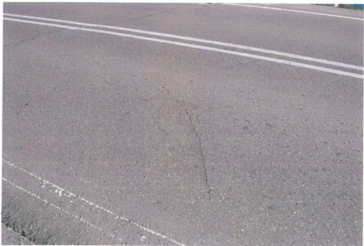
Fot. 10. Rysy nawierzchni jezdni na moście
