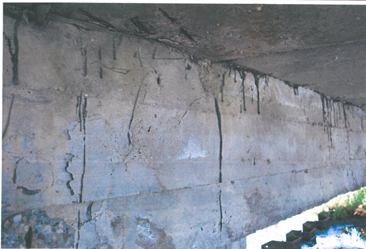
Fot. 22. Ubytki betonu, korozja betonu filaru mostu.
