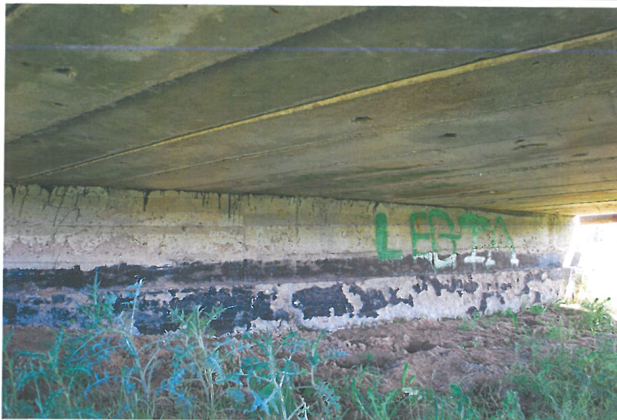
Fot. 19. Ubytki betonu, zanieczyszczenia przyczołka – widok od strony północnej.
