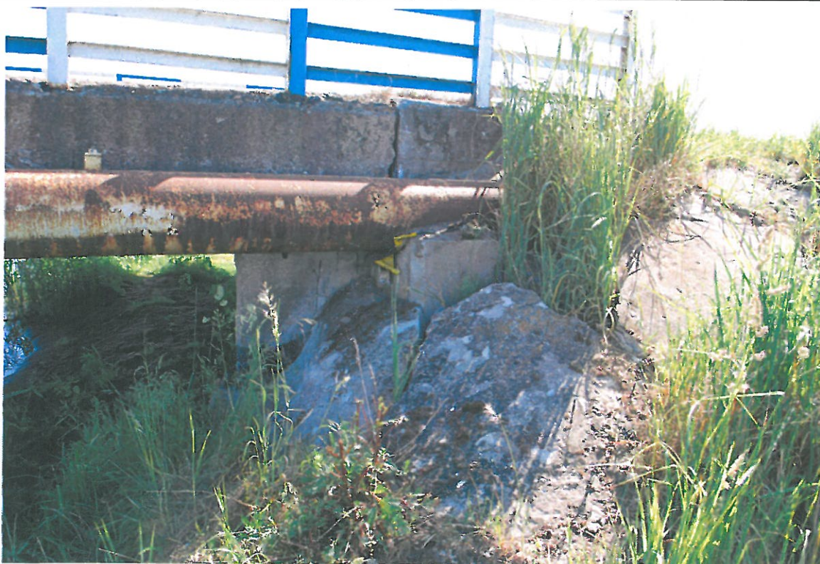
Fot. 6. Wegetacja roślin, ubytki i przemieszczenia betonu oraz zanieczyszczenia stożka spowodowane brakiem systematycznych prac utrzymaniowych (stożek od strony południowej – widok od strony dolnej wody)
