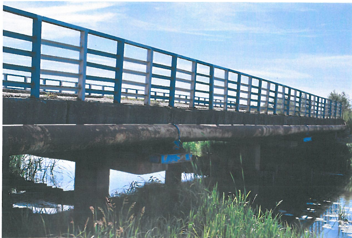
Fot. 26. Zniszczenie zabezpieczeń antykorozyjnych i korozja urządzeń obcych – widok od strony górnej wody.
