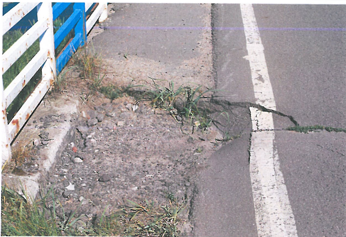
Fot. 7. Ubytek i deformacja nawierzchni jezdni w obrębie skrzydeł od strony południowej - widok od strony dolnej wody.
