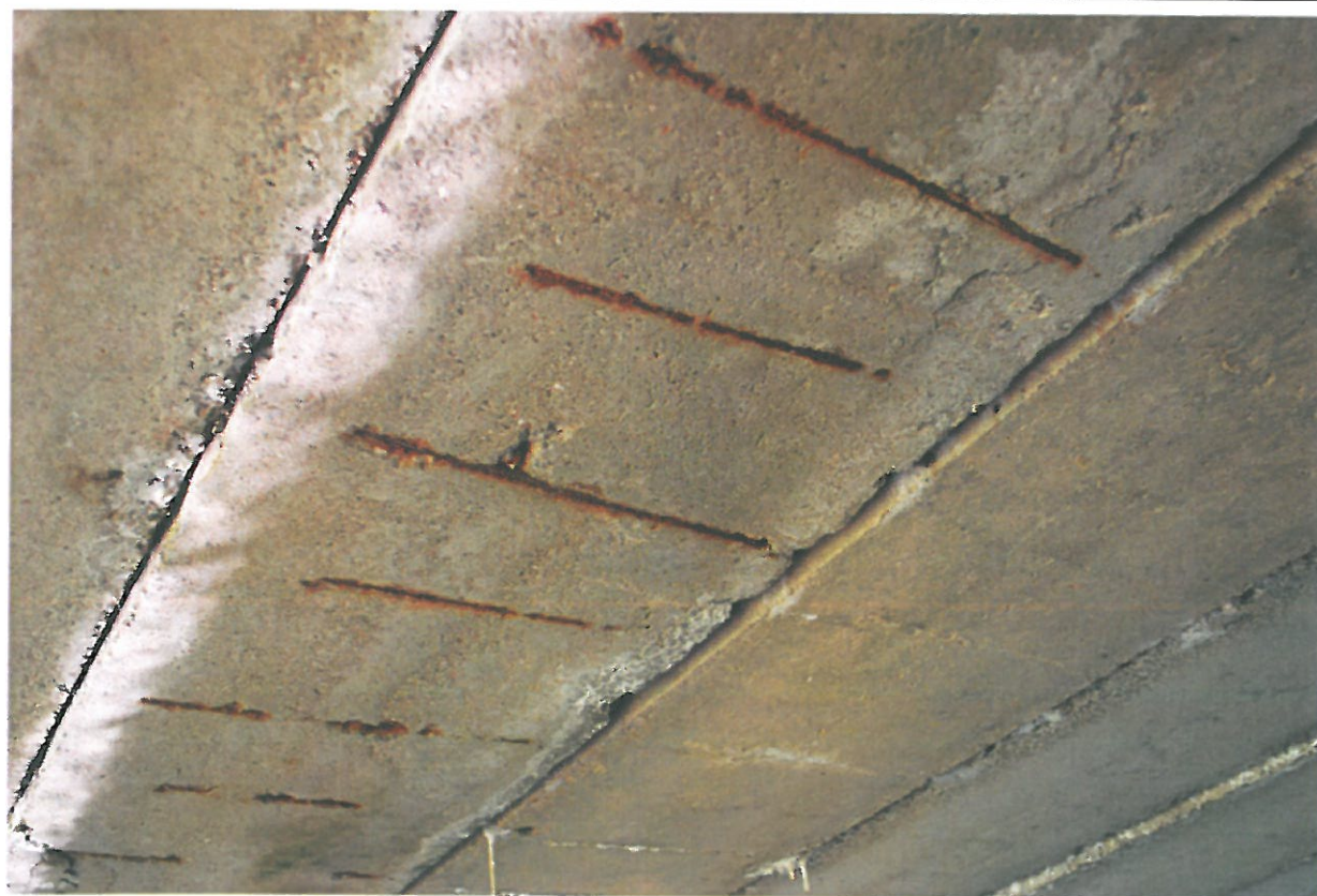
Fot. 16. Ubytki betonu, korozja betonu, korozja odsłoniętych prętów zbrojeniowych belek prefabrykowanych.
