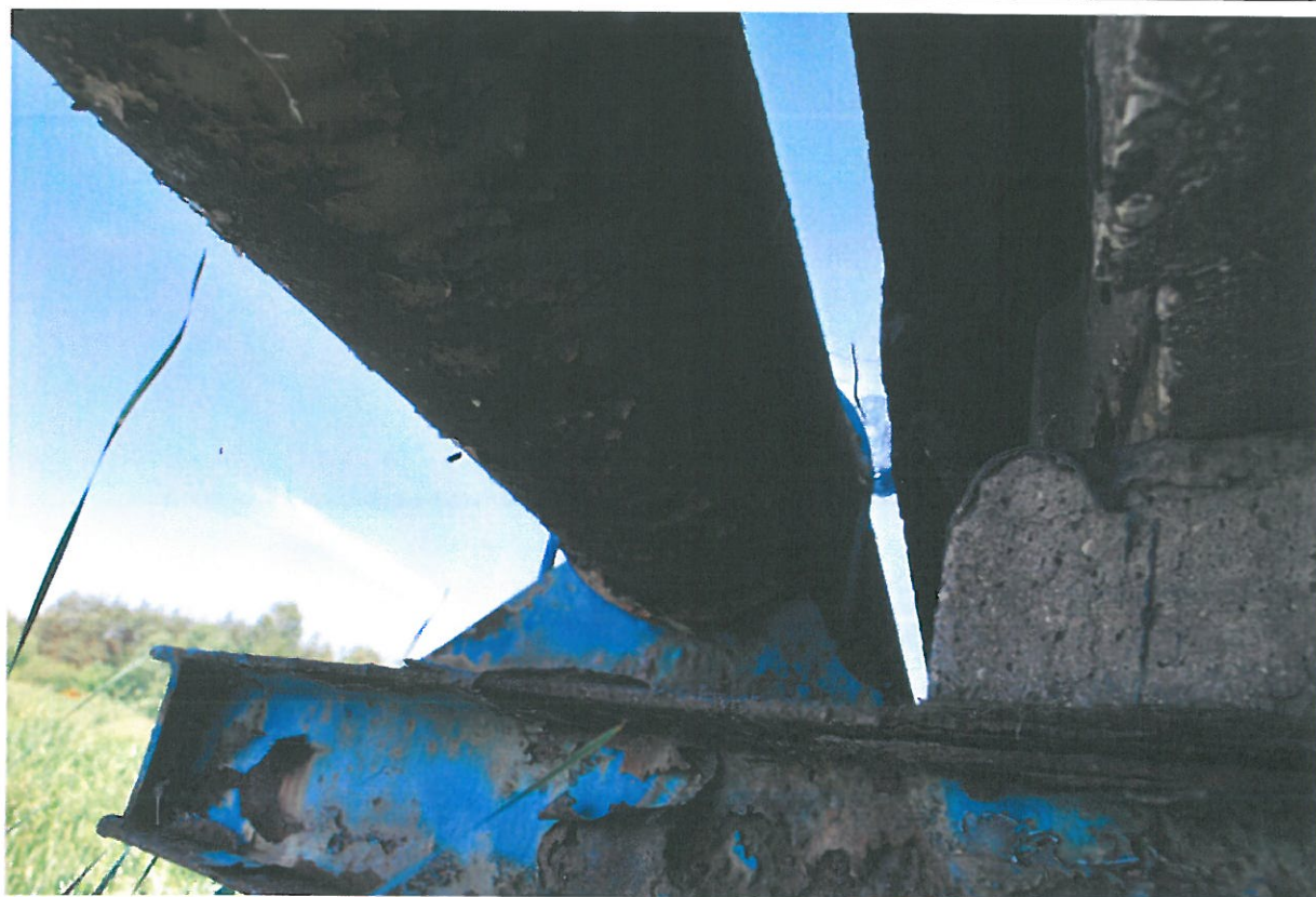
Fot. 24. Zniszczenie zabezpieczeń antykorozyjnych i korozja urządzeń obcych
