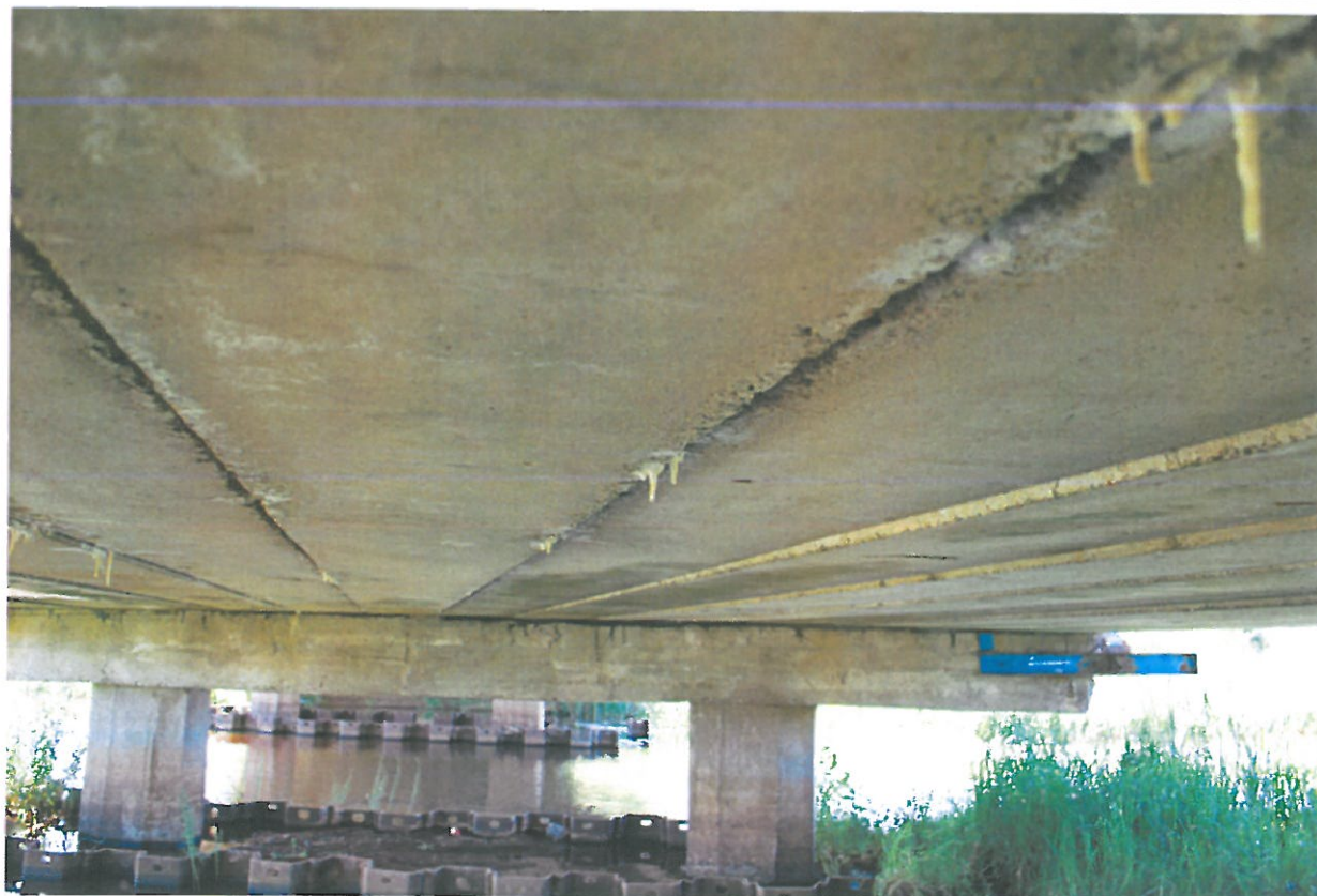
Fot. 15. Przecieki pomiędzy belkami prefabrykowanymi świadczące o braku skuteczności izolacji.
