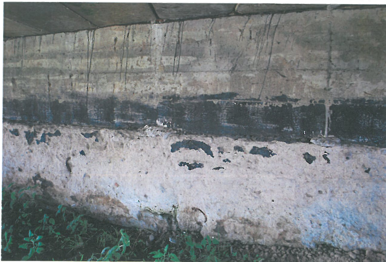
Fot. 20. Ubytki betonu, zanieczyszczenia przyczołka – widok od strony południowej.
