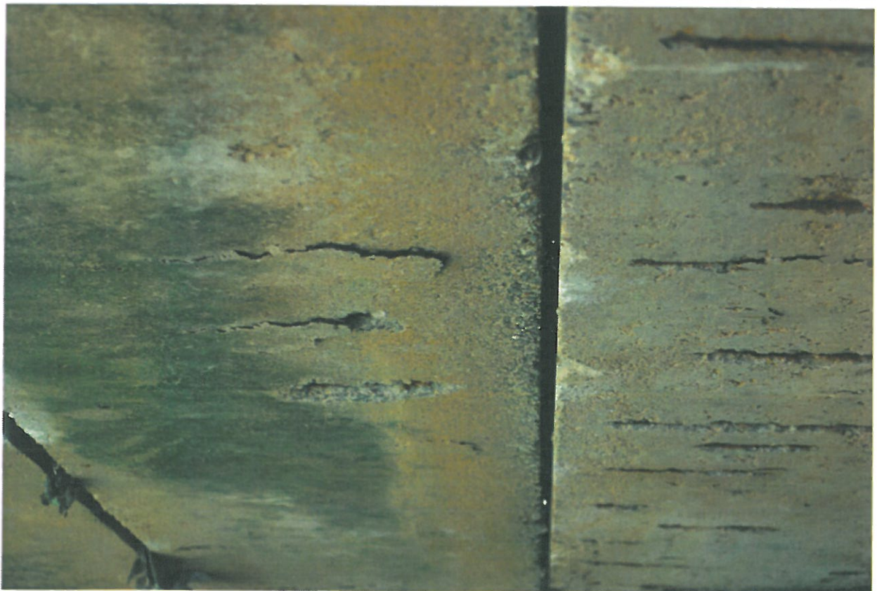
Fot. 18. Ubytki betonu, korozja betonu, korozja odsłoniętych prętów zbrojeniowych belek prefabrykowanych.
