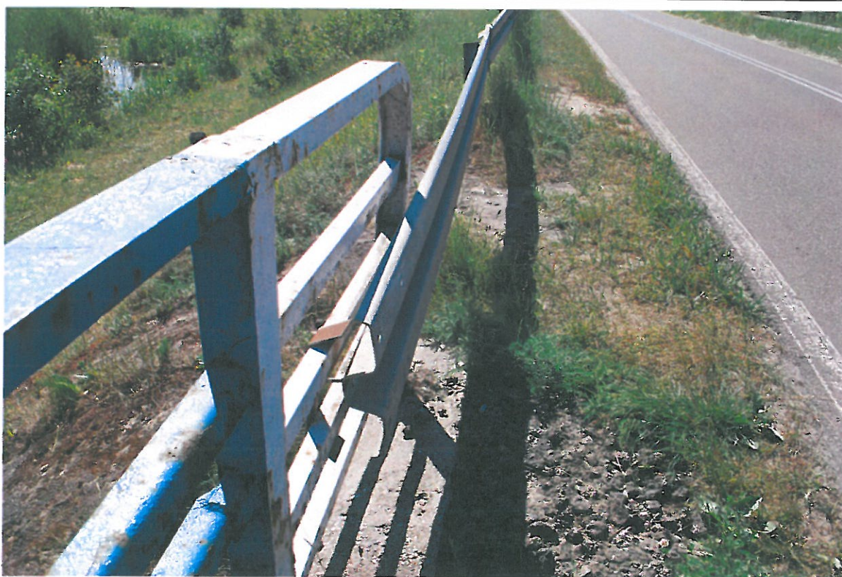
Fot. 12. Nieprawidłowe dowiązanie bariery drogowej do balustrady mostowej.
