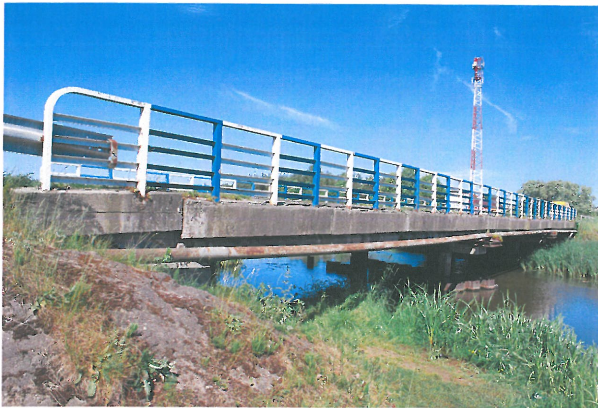
Fot. 25. Zniszczenie zabezpieczeń antykorozyjnych i korozja urządzeń obcych – widok od strony dolnej wody.
