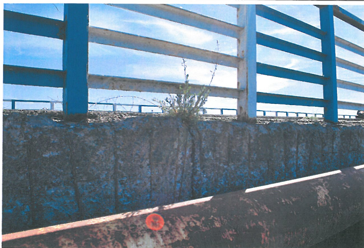
Fot. 14. Ubytki betonu i korozja stali zbrojeniowej gzymsu – widok od strony dolnej wody
