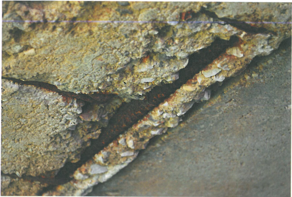
Fot. 17. Ubytki betonu, korozja betonu, korozja odsłoniętych prętów zbrojeniowych belek prefabrykowanych.
