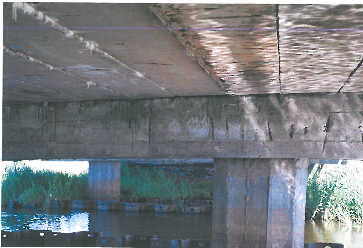
Fot. 21. Ubytki betonu, korozja betonu, korozja odsłoniętych prętów zbrojeniowych filaru mostu.
