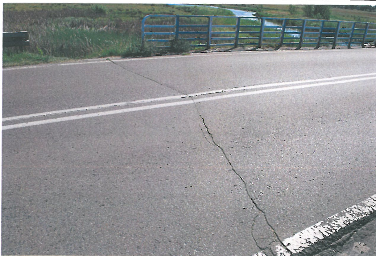
Fot. 8. Rysy w nawierzchni jezdni na dojeździe od strony północnej.
