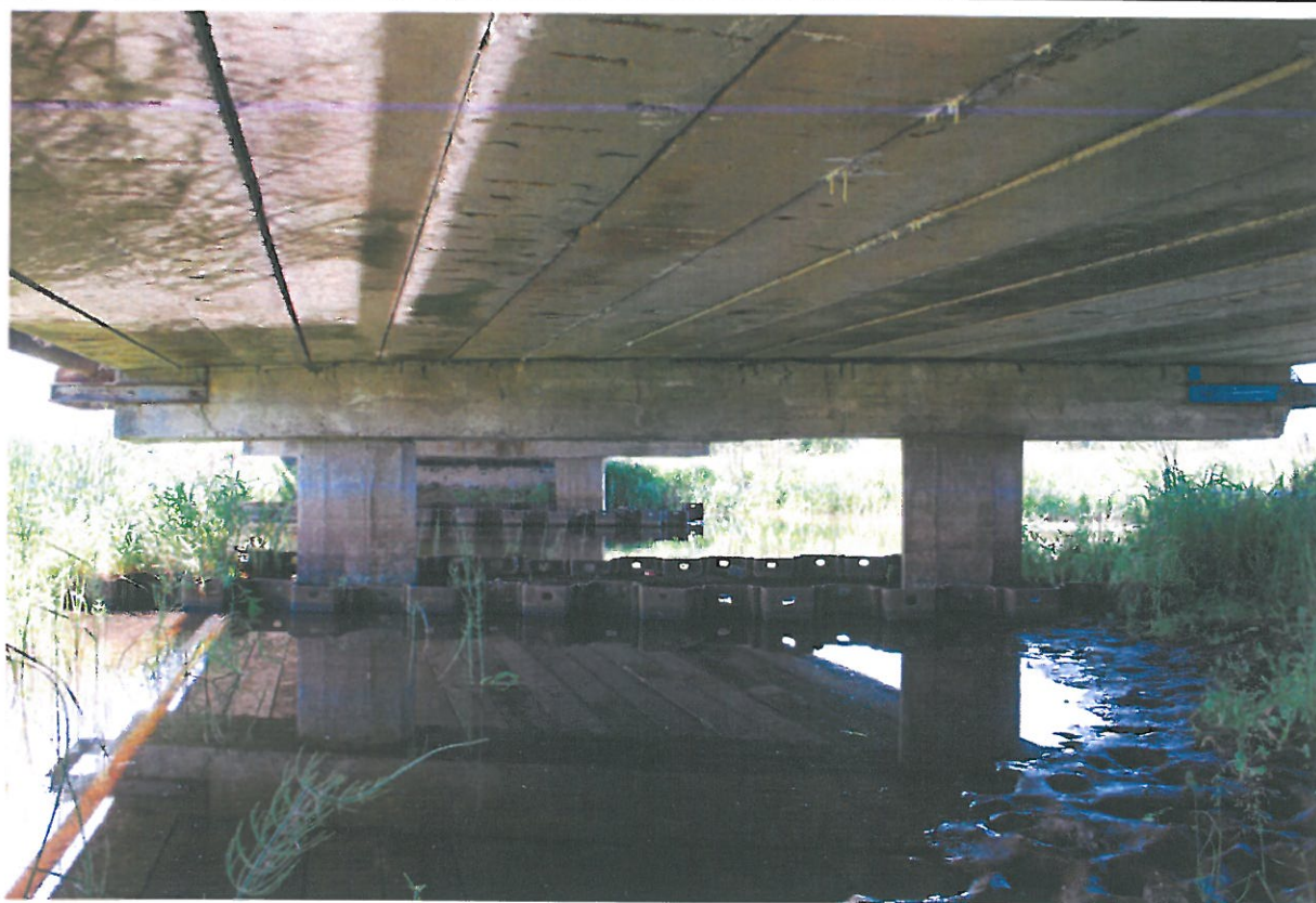
Fot. 23. Brak umocnienia przestrzeni podmostowej może spowodować podmycie przyczółka.
