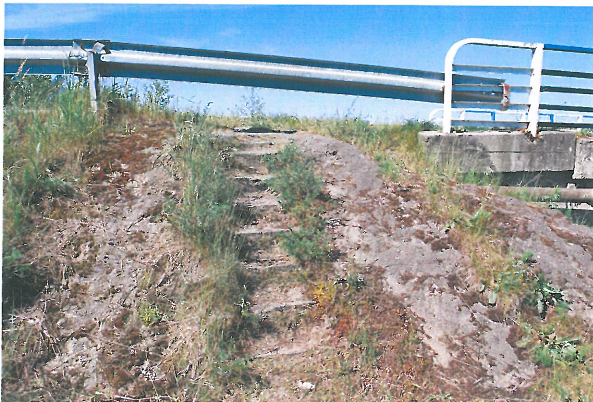
Fot. 5. Wegetacja roślin oraz zanieczyszczenia stożka i schodów skarpowych spowodowane brakiem systematycznych prac utrzymaniowych (stożek od strony południowej – widok od strony górnej wody)
