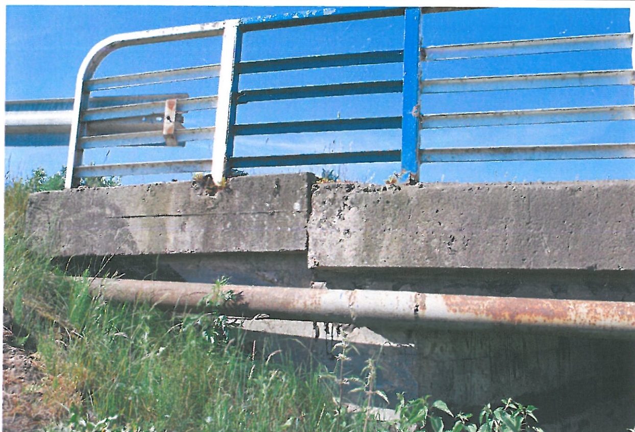
Fot. 13. Przemieszczenie prefabrykowanego gzymsu – widok od strony górnej wody (str. południowa)
